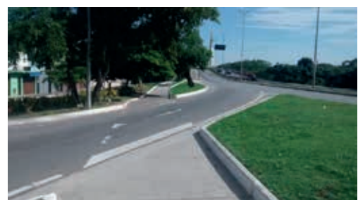
Cruzamento cicloviário marcado com FTP desgastada, sem sinalização específica.
